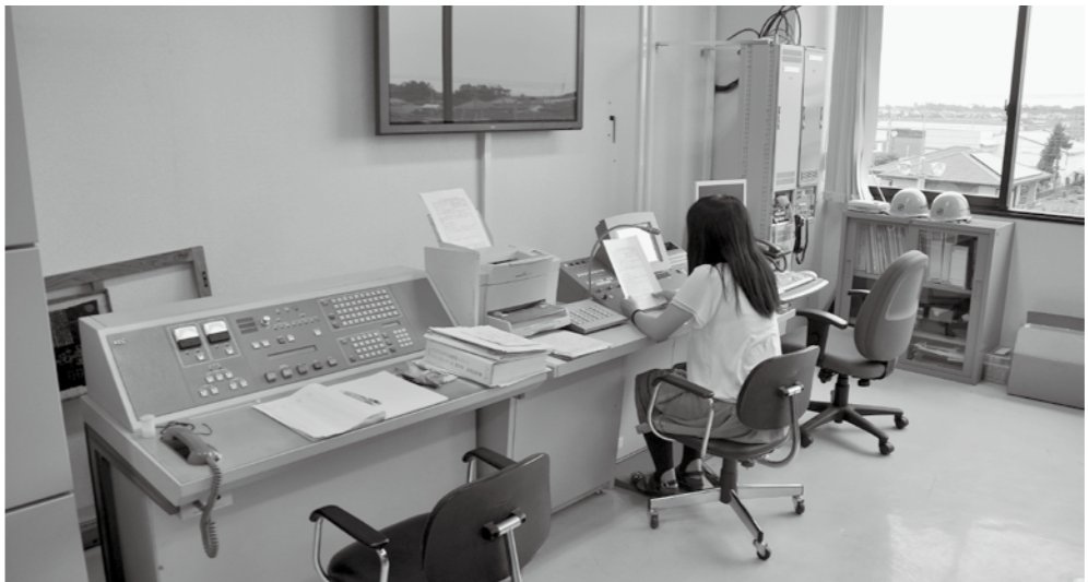
防災行政無線固定局（一宮町保健センター3階）
