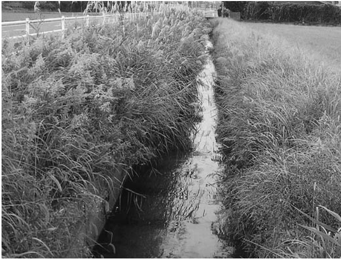
陥没に見まわれる水路
