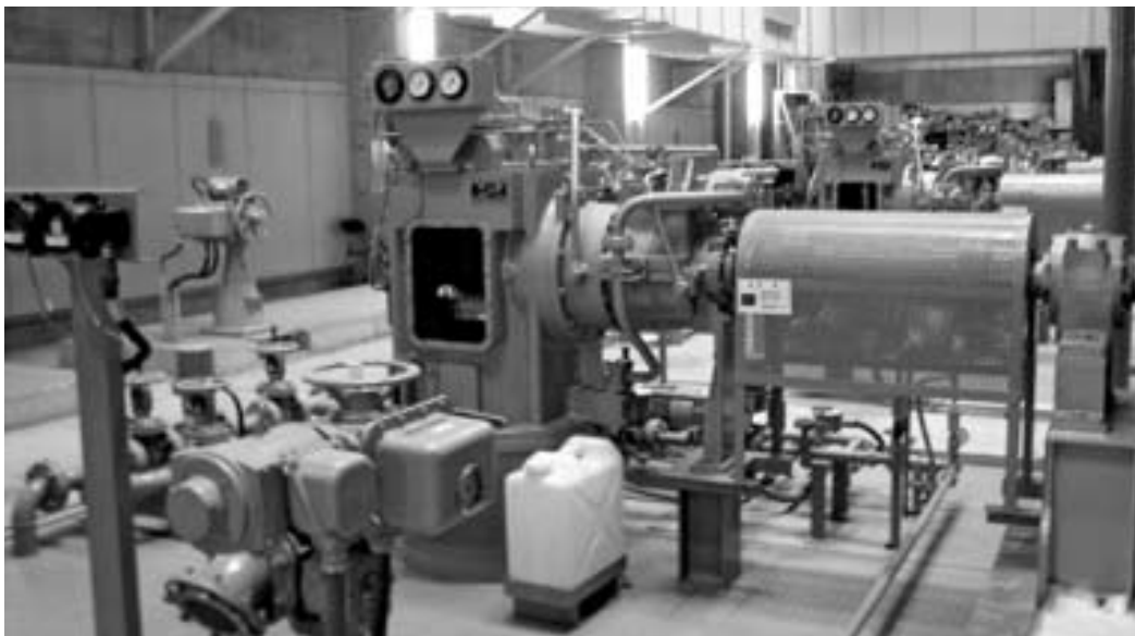
災害に備えてオーバーホールした一宮中央ポンプ場3号機
